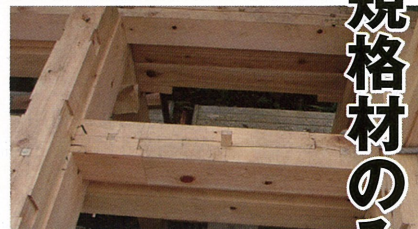
4寸角梁を相欠きで格子状に組むことで床剛性を確保する
